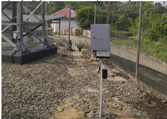
Gambar 3. Pengujian Sensor PIR di PT. PLN UPT KALTIMRA.
